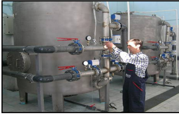
Resim 2.8. Klor dozajlama ünitesi [3].
