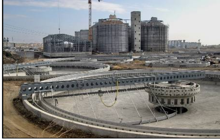
Resim 2.14. Paşaköy Biyolojik Arıtma Tesisi [52]
