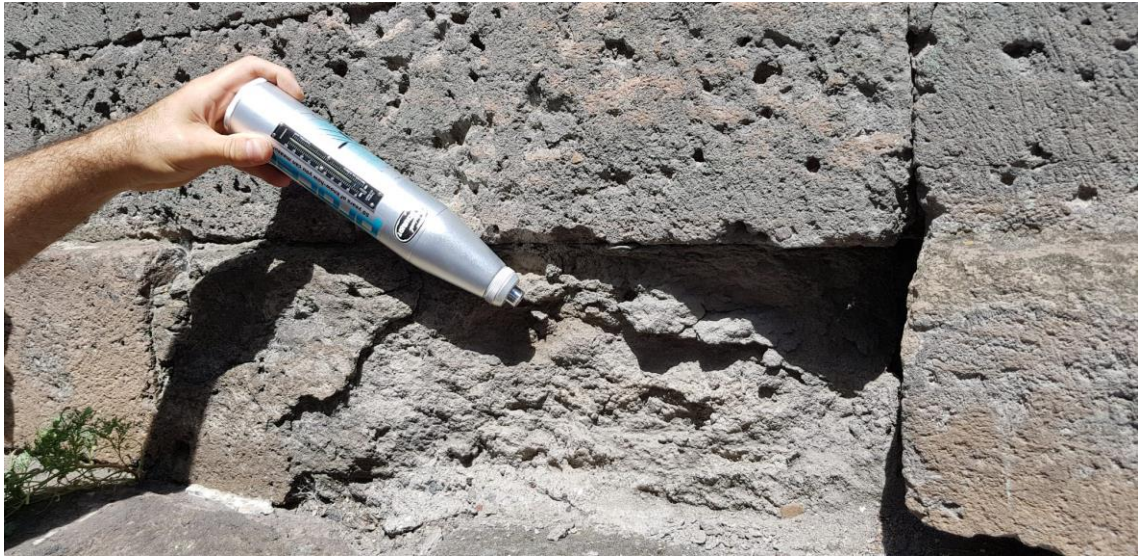
Şekil 6. 7 Selçuklu Emir 2 Kümbeti'nde yapının alt kesimlerinde görülen malzeme kayıpları
