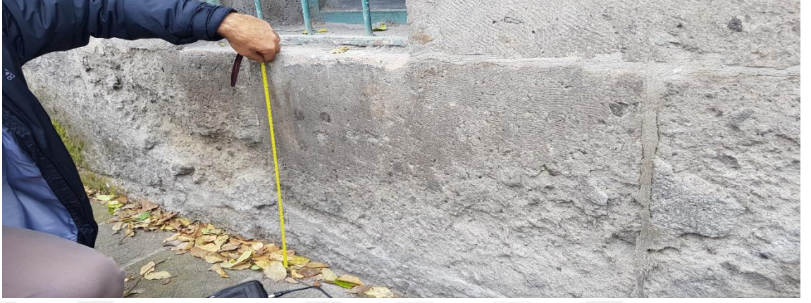
Şekil 6. 16 Suyun tahliye olamadığı bölgede görünen kavlaklanma ve blokların aralarının çimento ile doldurulması
