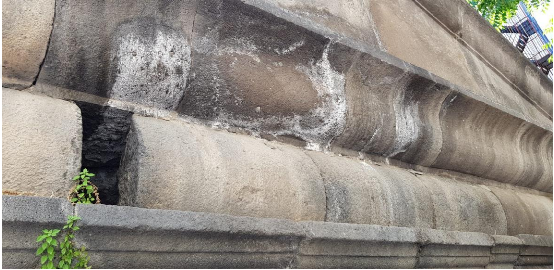
Şekil 6. 1 Roma Mezarı'nda tuzlanma ve derz boşluklarında bitki büyümeleri
