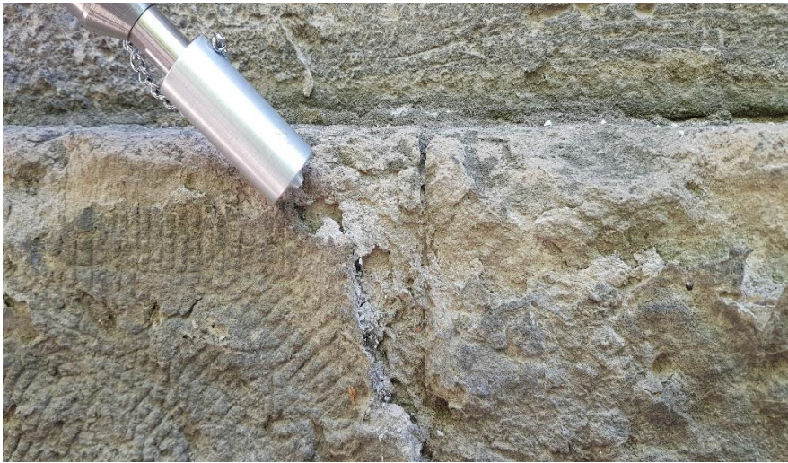
Şekil 5. 11 Selçuklu Emir 2 Kümbeti'nde ignimbiritlerde gözlenen pullanma (kavlaklanma)
