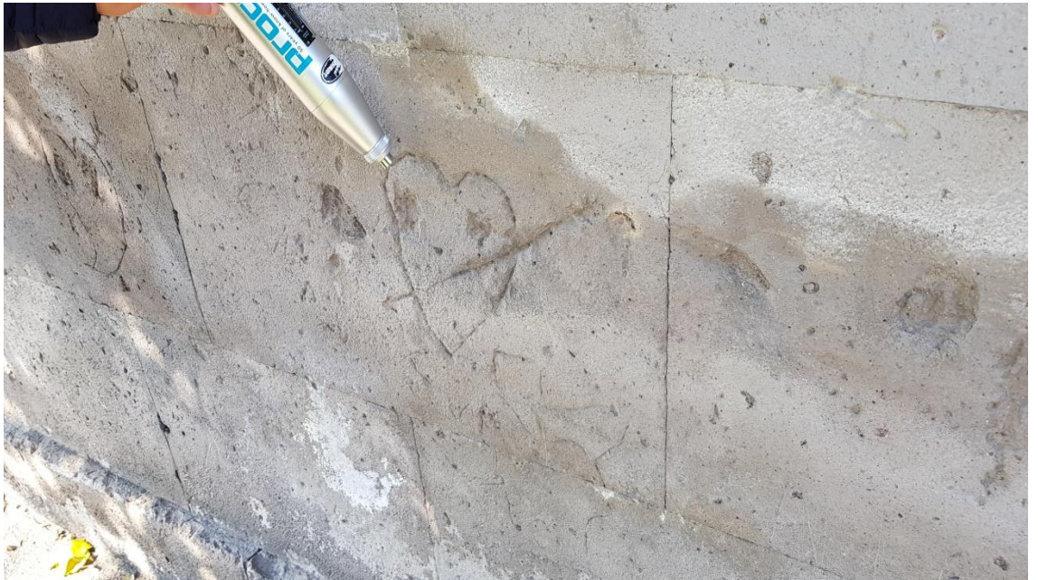
Şekil 6. 37 Emir Ali Pişrev Kumbeti'nde insan kaynaklı tahribatlar
