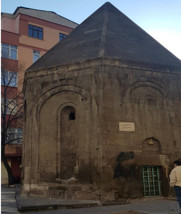
Şekil 5. 12 Selçuklu Emir-1 Kumbeti çatı taş yüzeylerinde gözlenen kararma
