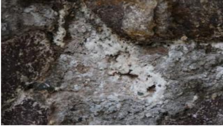
Şekil 5. 10 Sur duvar örgüsünde tuzlanma (çiçeklenme) [43]
