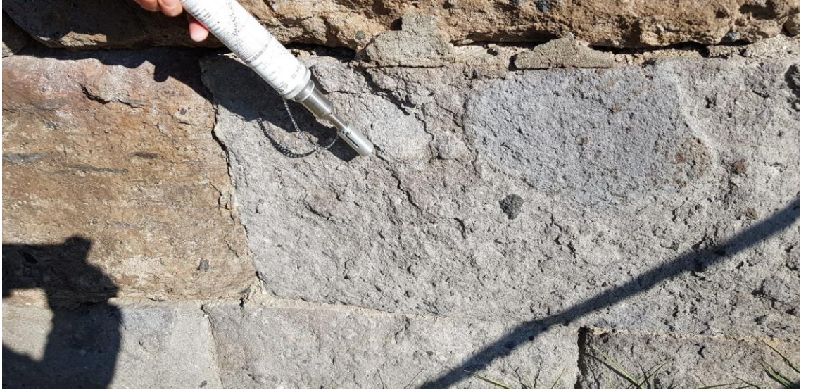
Şekil 6. 19 Çifte Kümbet'te alt bölgelerde görülen pullanma ve kavlaklanma türü bozunmalar
