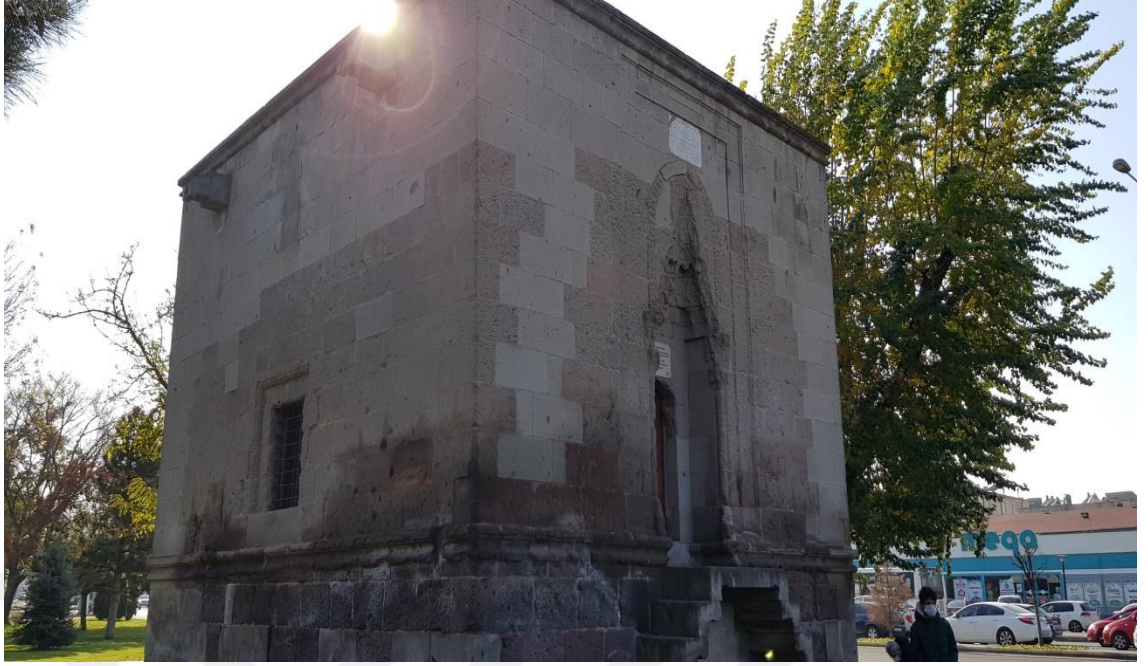
Şekil 6. 36 Emir Ali Pişrev Kumbeti'nin alt kısmında görülen tuzlanma ve kararmalar
