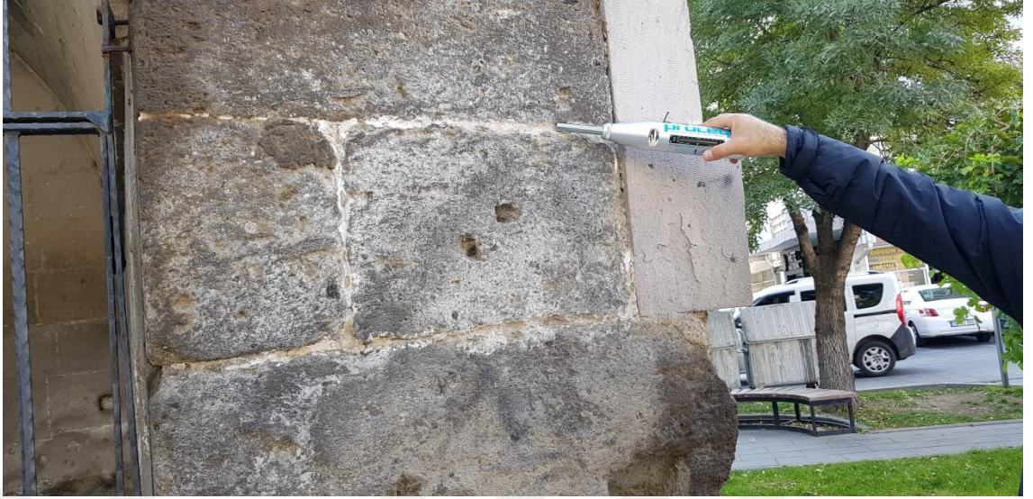
Şekil 6.29 Babükbey Kümbeti'ndeki çimento malzemesi etrafında tuzlanma, kavlaklanma, renk değişimleri
