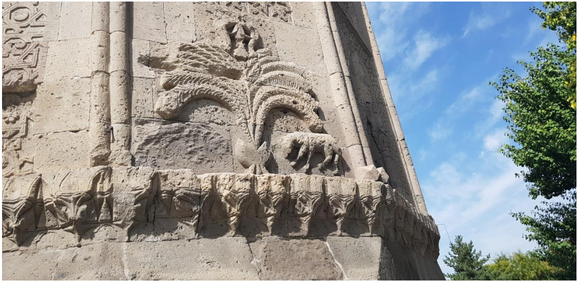
Şekil 6. 24 Döner Kümbet'in dış yüzeyinde bulunan motiflerin bozunma etkisiyle tahribatı
