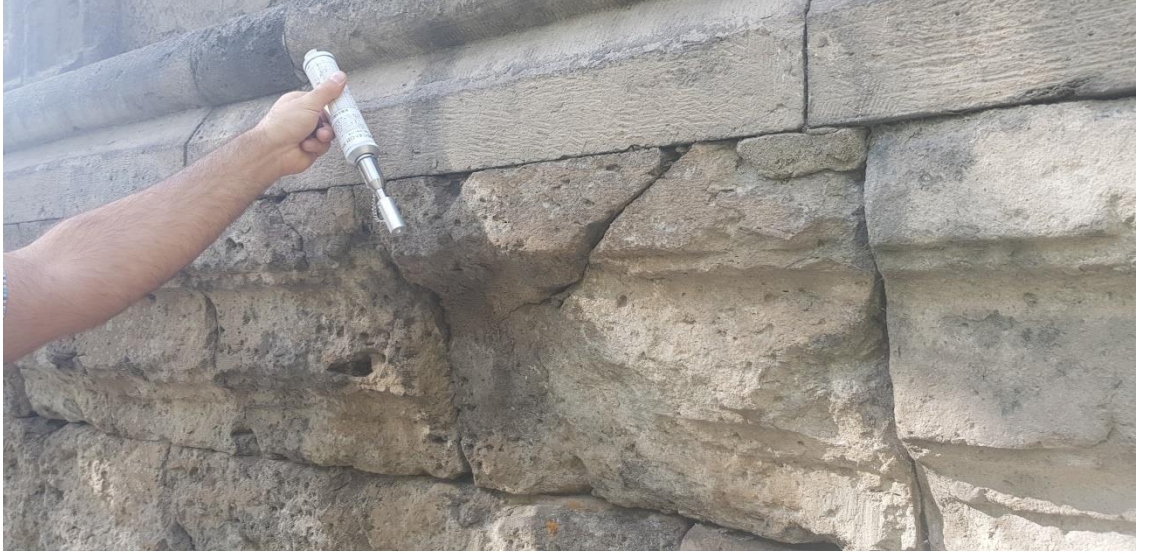
Şekil 5. 4 Ali Cafer Kümbeti’nde kaya malzemesinde gözlenen çatlak oluşumları
