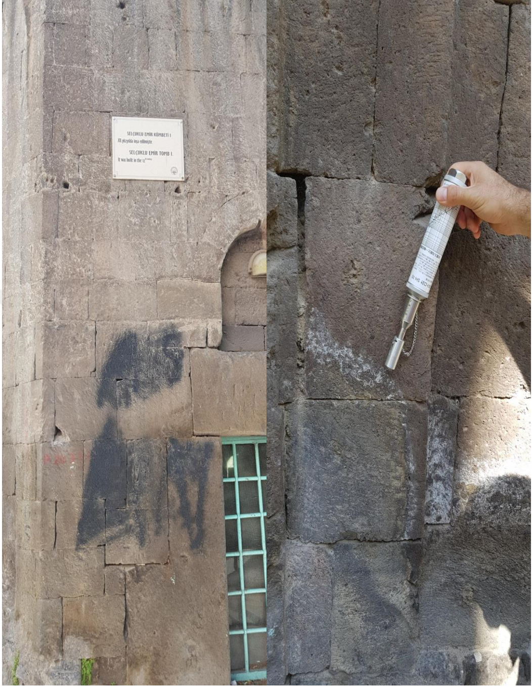
Şekil 6. 4 Selçuklu Emir 1 Kumbeti'nde ignimbirit bloklarında gözlenen tuz oluşumu, insan tahribatları
