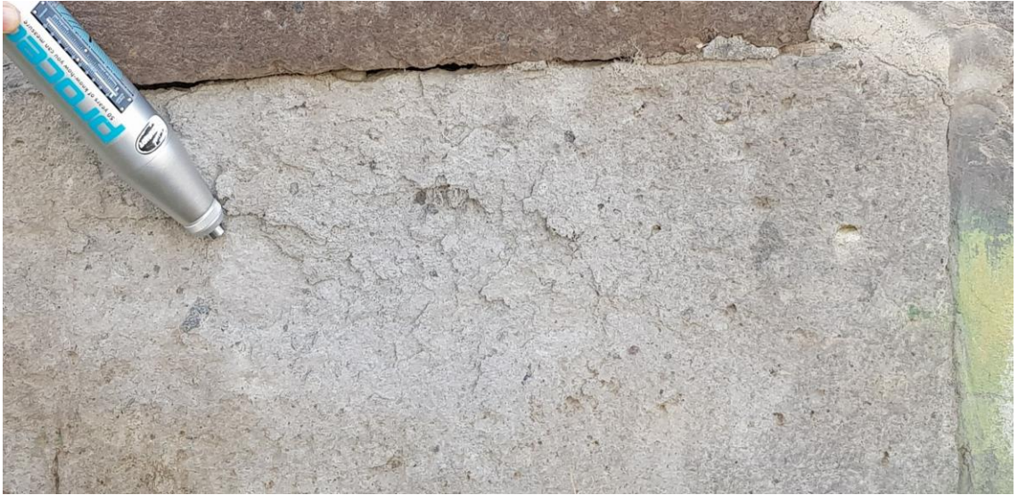
Şekil 6.12 Köşk Medresesi'nde sonradan kullanılan ignimbirit malzemesinde görülen kavlaklanma
