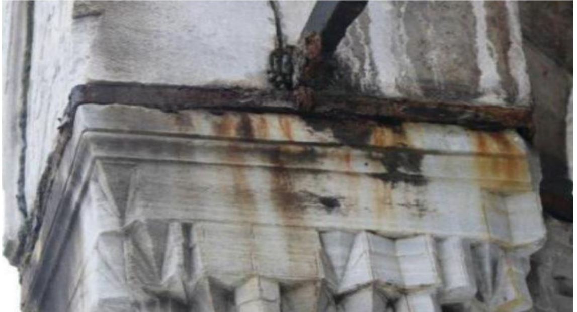
Şekil 5. 16 Sultan Ahmet Camii'nin beyaz mermer sütun başlığının demir kasnağının korozyonunun üzerine akması sonucu renk bozulması [43]
