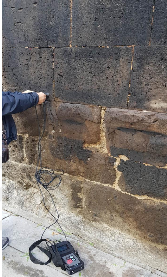
Şekil 5. 2 Çalışma kapsamında incelenen Babükbey Kümbeti'nin insanlar tarafından yakılarak tahrip edilen kesimi
