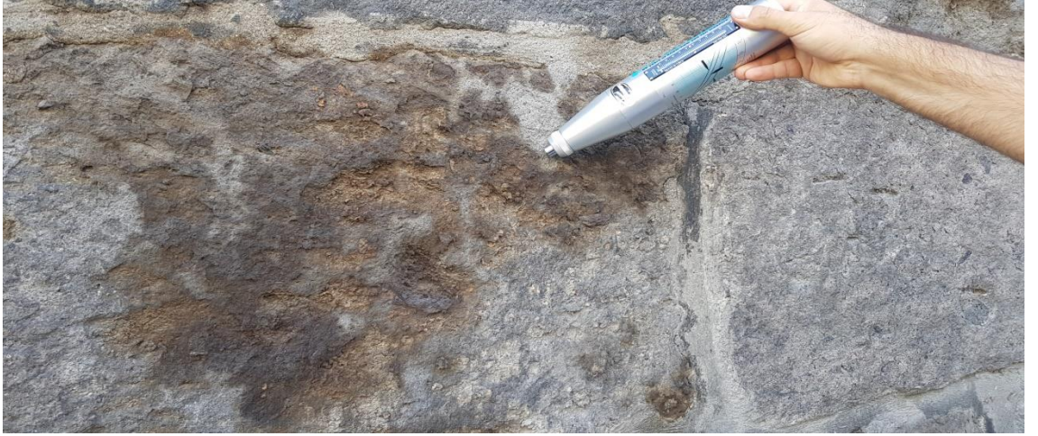
Şekil 6. 17 Suyun tahliye olamadığı bölgede görünen yosunlanma ve kavlaklanma bozunmaları
