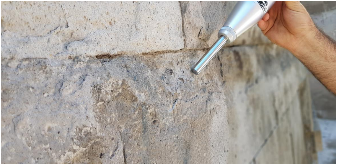
Şekil 6. 14 Hacıp Çavlı Kümbetinin yan duvarlarında bozunma etkisiyle meydana gelen pullanma ve kavlaklanma
