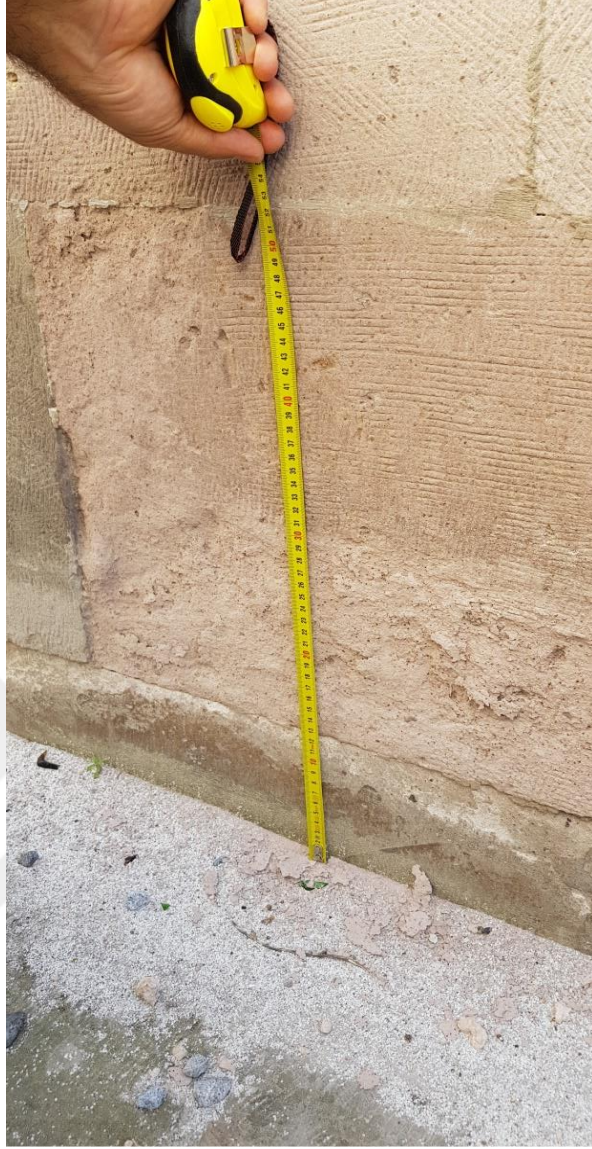
Şekil 5. 14 Hacıp Çavlı Kümbeti'nde restore edilen blokta kısa zamanda meydana gelen tozlaşma
