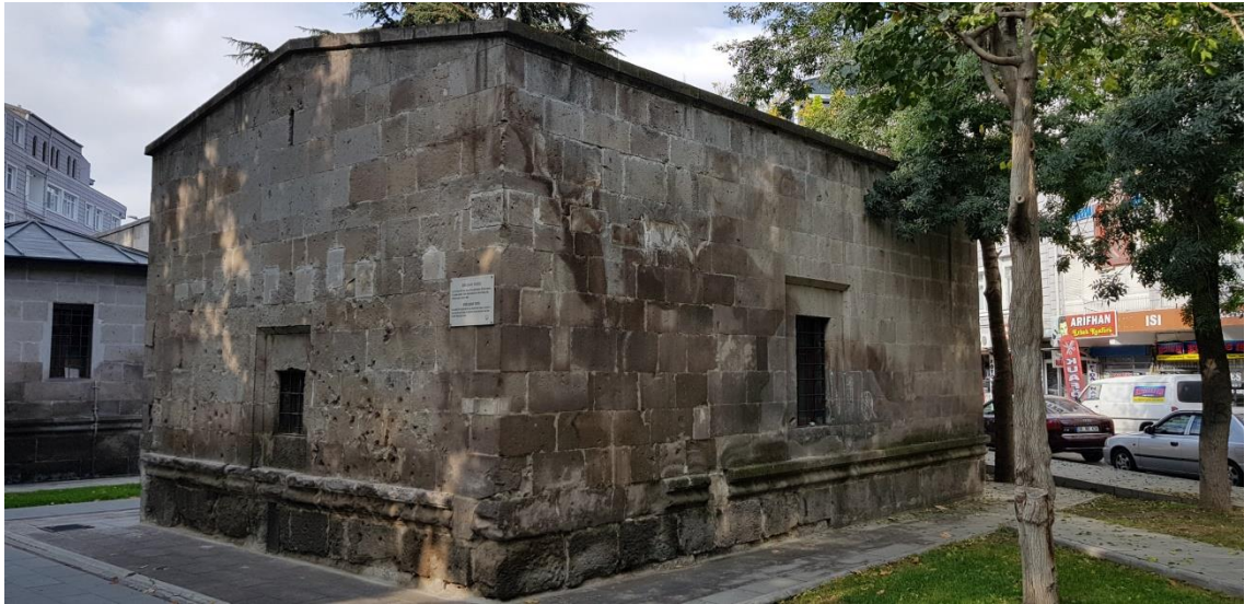
Şekil 6.32 Emir Ali Şahap Kumbeti’nde gözlenen kararma ve tuzlanmalar
