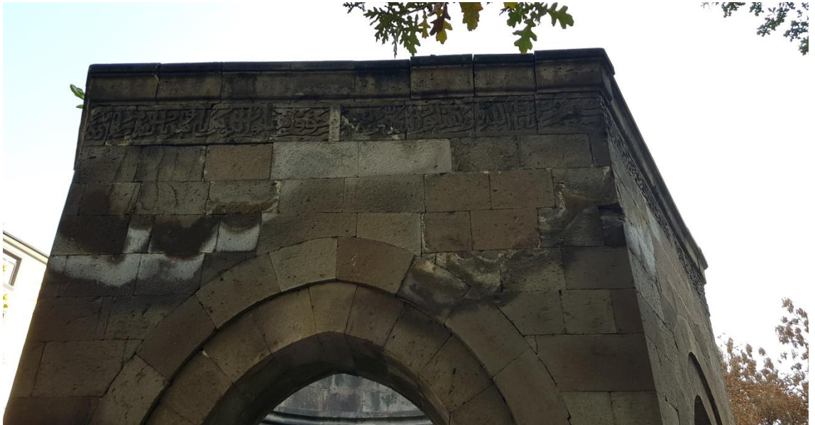
Şekil 5. 9 Suyakanmış Hatun Kümbeti'nde çatı bölgesinde gözlenen tuzlanma
