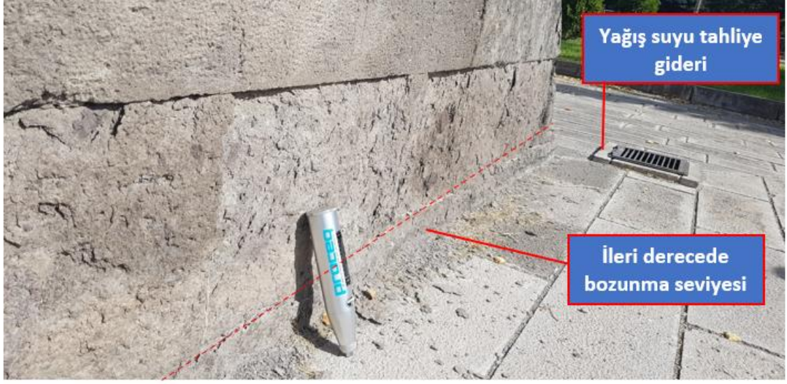
Şekil 6. 25 Döner Kümbet çevresinde yağış sularının tahliyesi için yerden 5-10 cm yüksekte imal edilen su giderlerinden bir görünüm
