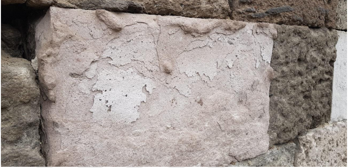
Şekil 6.11 Köşk Medresesi restorasyonu sırasında yerleştirilen ignimbirit malzemesinde meydana gelen pullanma ve kavlaklanma
