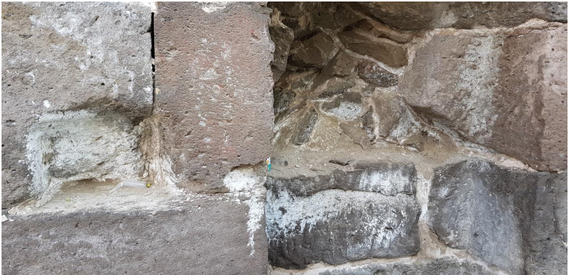
Şekil 6. 28 Babükbey Kümbeti'nde tuzlanma ve ignimbirit blokları arası derz boşalmaları
