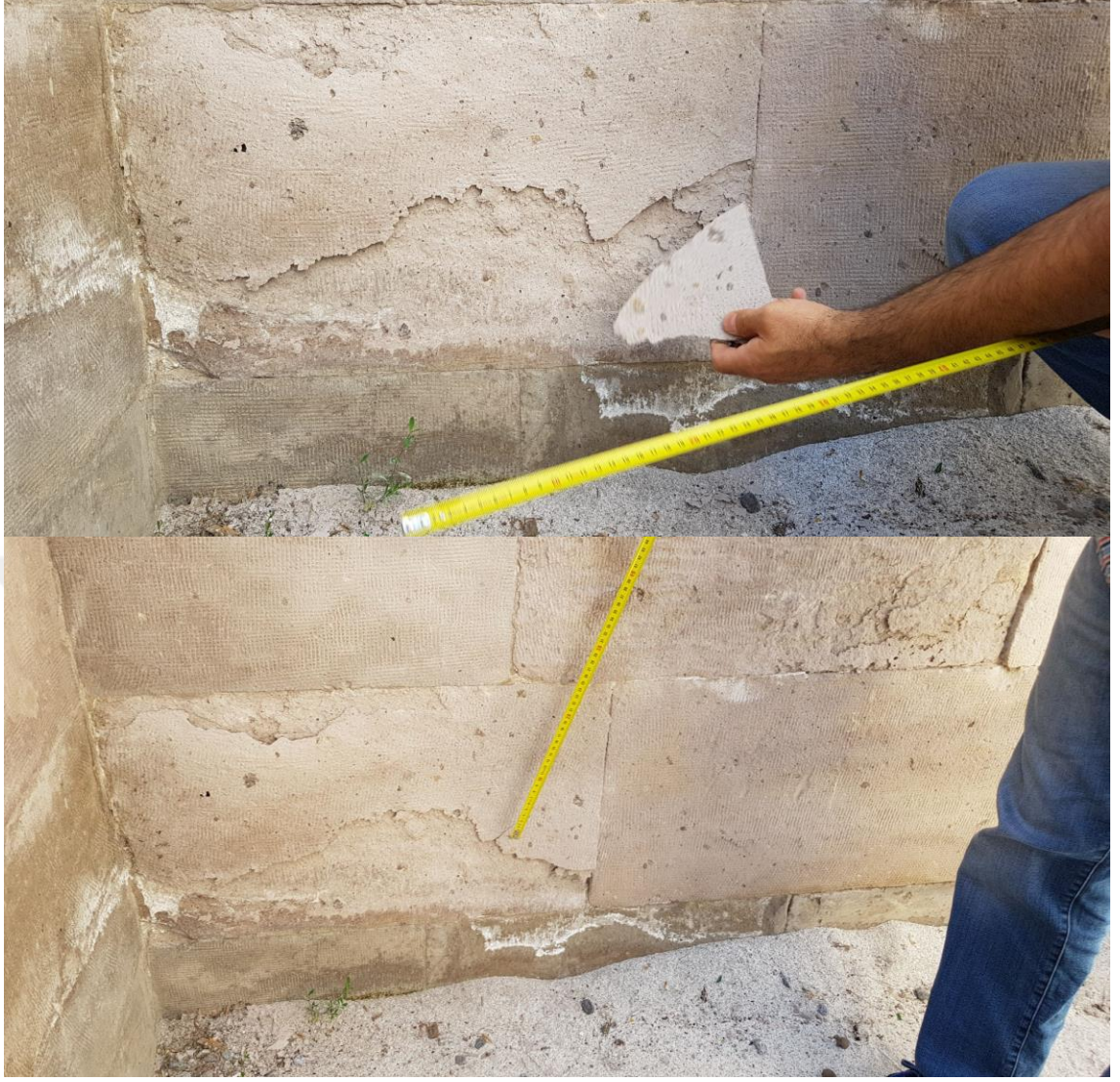
Şekil 6. 15 Hacip Çavlı Kümbetinin yan duvarlarında restorasyon malzemesinde görülen tuzlanma, kavlaklanma ve tozlaşma
