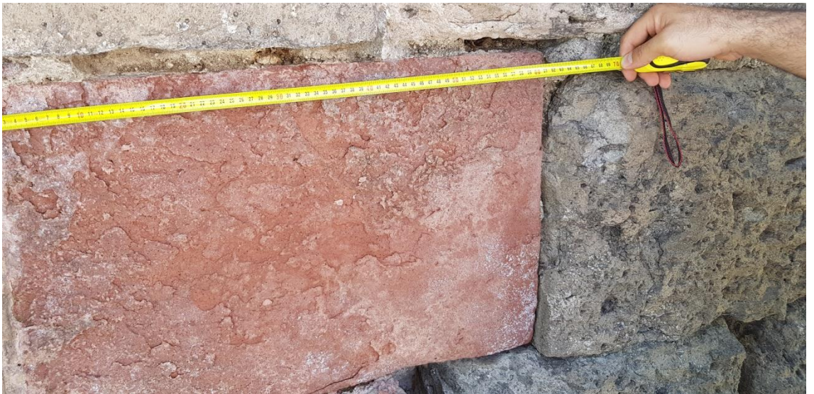
Şekil 6. 21 Ali Cafer Kümbeti'nde derz araların çimento harcının dağılması, petegözlülük, kavlaklanma
