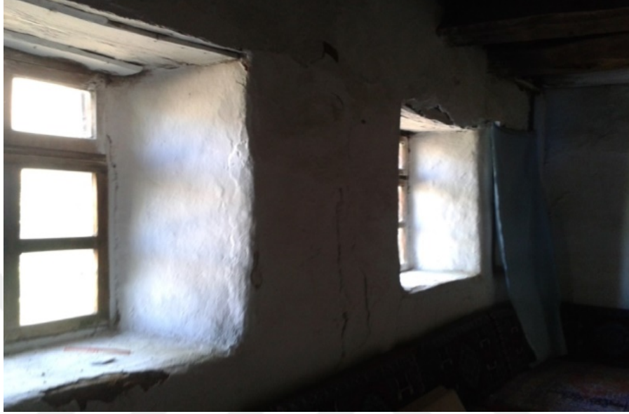
Foto 3.35. Ayvat Kırşal Mahaltesinde Bulunan Geleneksel Mimariyle Yapılmış Evlerden Birinin Kalın Dış Duvarları.
