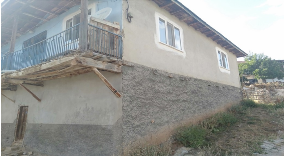
Foto 3.34. Sonradan Dış Sıvası Yenilenmiş Olan Bu Evin Zemin Katının Arka Tarafı Toprağın İçerisine Gömülü Haldedir.
