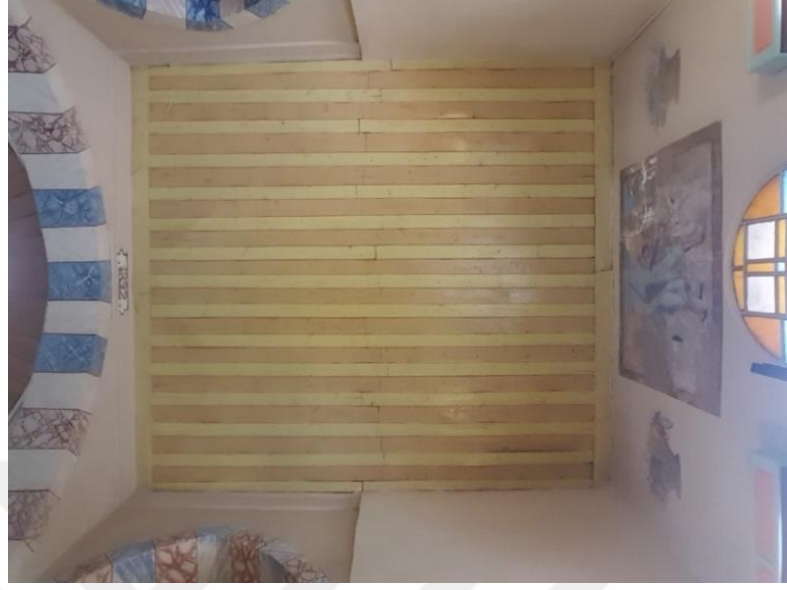
Şekil 3.74. Haralambos Sultanidis Konağı Giriş Bölümü Düz Tavan Görünümü Konağın giriş kapısı alanında sarı ve açık kahve renklerle renklendirilmiş, düz tavan tekniği uygulanmış ahşap tavan bulunmaktadır.
