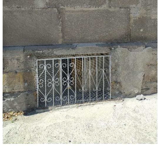
Fotoğraf 21. Bodrum kat doğu duvardaki pencere açıklığı
