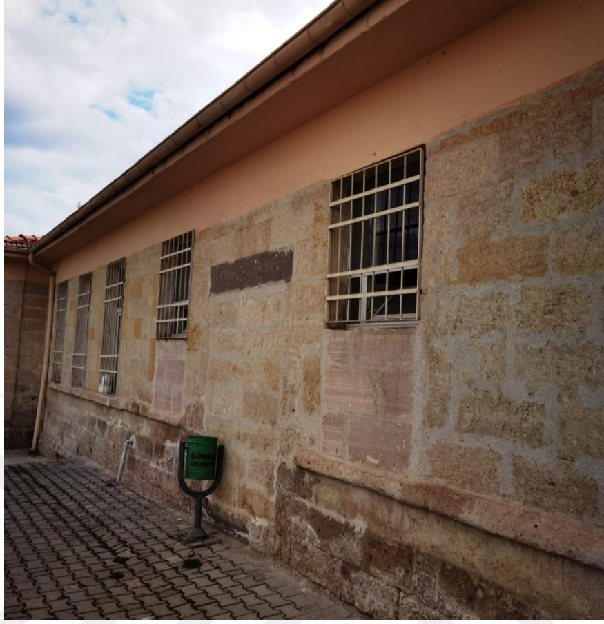
Fotoğraf 212. Kuzey cephe arka bahçeye giriş kısmının kapatılmış hali
