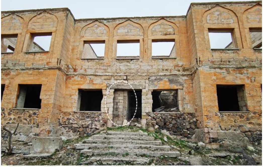
Fotoğraf 138. Zemin kat giriş kapısını engelleyen derslik duvarı
